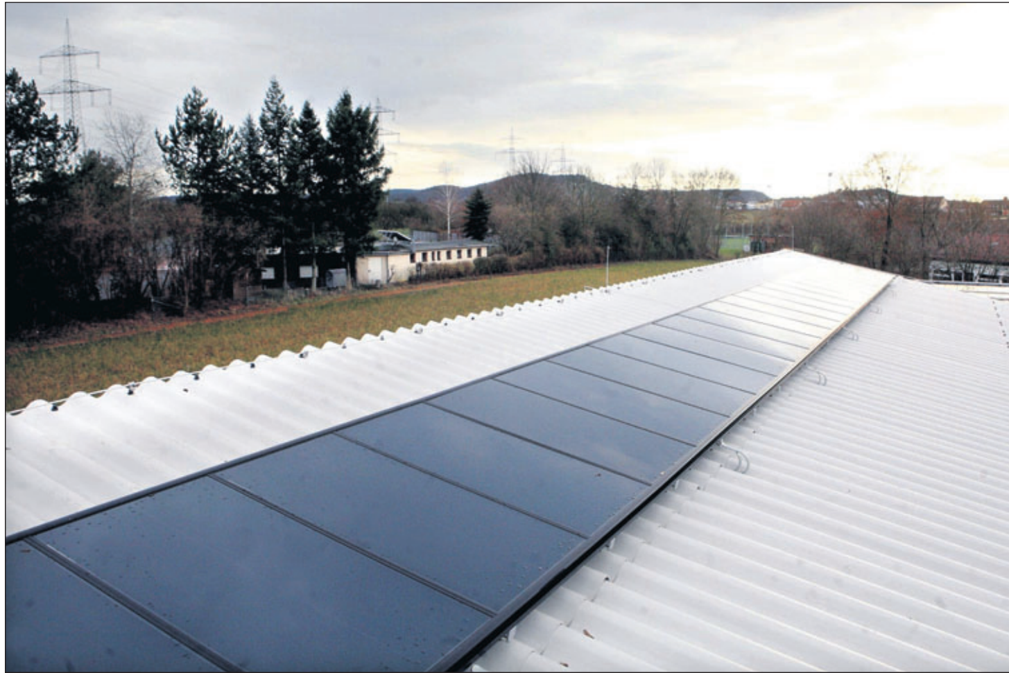
Hohenacker tankt Sonnenkraft: So sehen die Fotovoltaikmodule auf dem Dach des Schulhorts aus.
